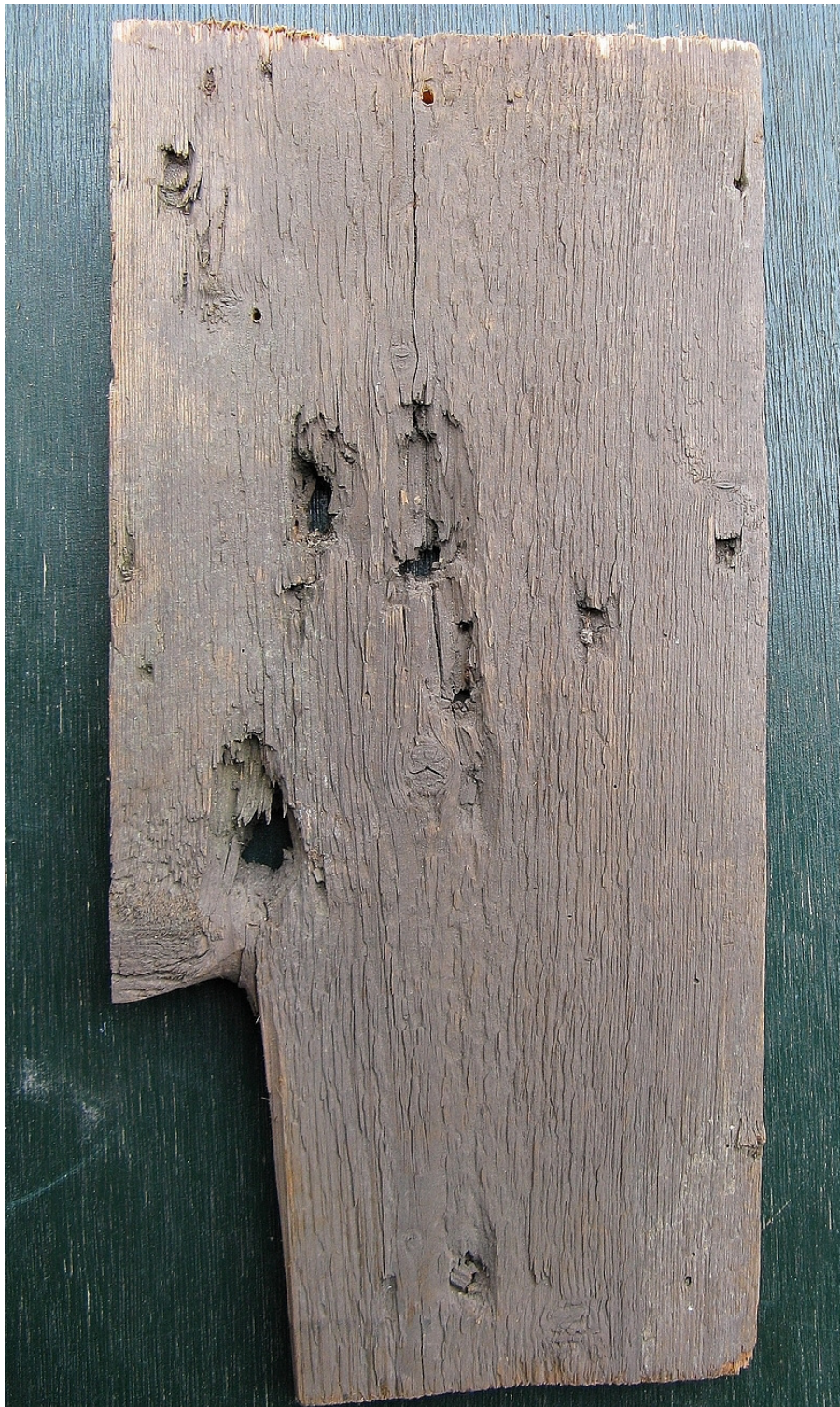
Scherven in het dakbeschot van Rijksweg 122. Schade ontstaan op 12 oktober 1944.
